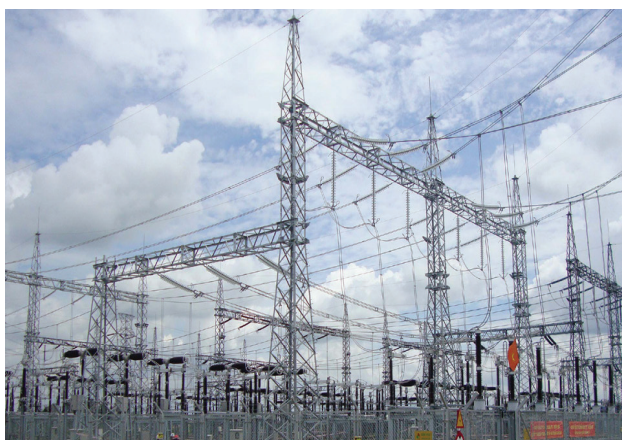
Trạm điện 110 thành phố Lai Châu
